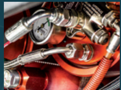
Löschanlage und Dieselpartikelfilter gemäß den Anforderungen im Tunnelbau.
